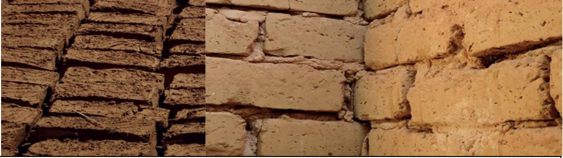
صورة 1-2 تبين شكل الطوب اللبن المصدر: البناية الطينية وصيانتها بوادي مزاب الجزائر
